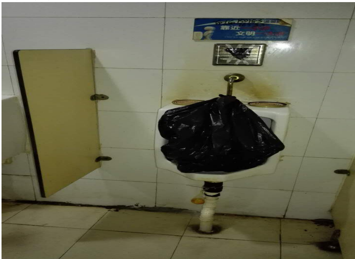
厕所小便池损坏后未修复，维护不及时。
