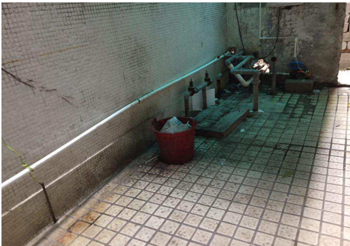
垃圾清理不及时，垃圾桶无盖，地面脏乱。
