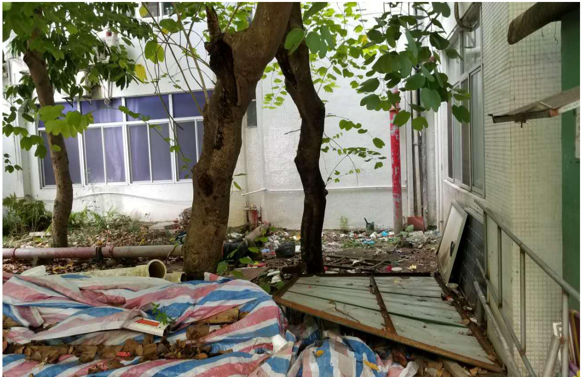
工地杂乱无章，可见垃圾杂物。
